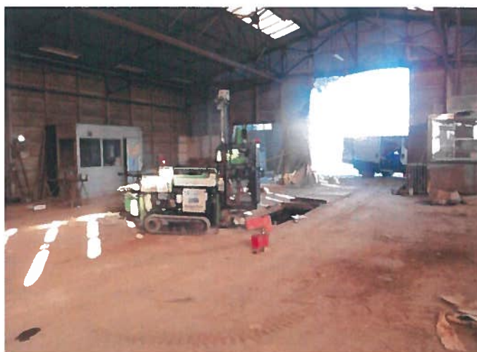
MOY 2 : Cuve enterrée de séparation des huiles moteur usagées
